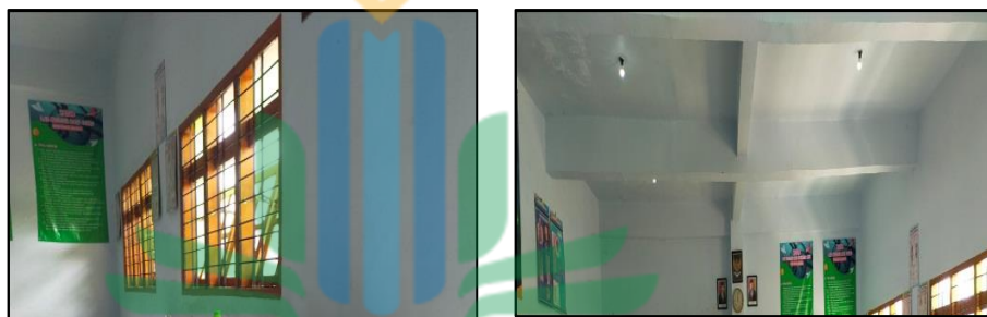
Ventilasi ruang laboratorium
