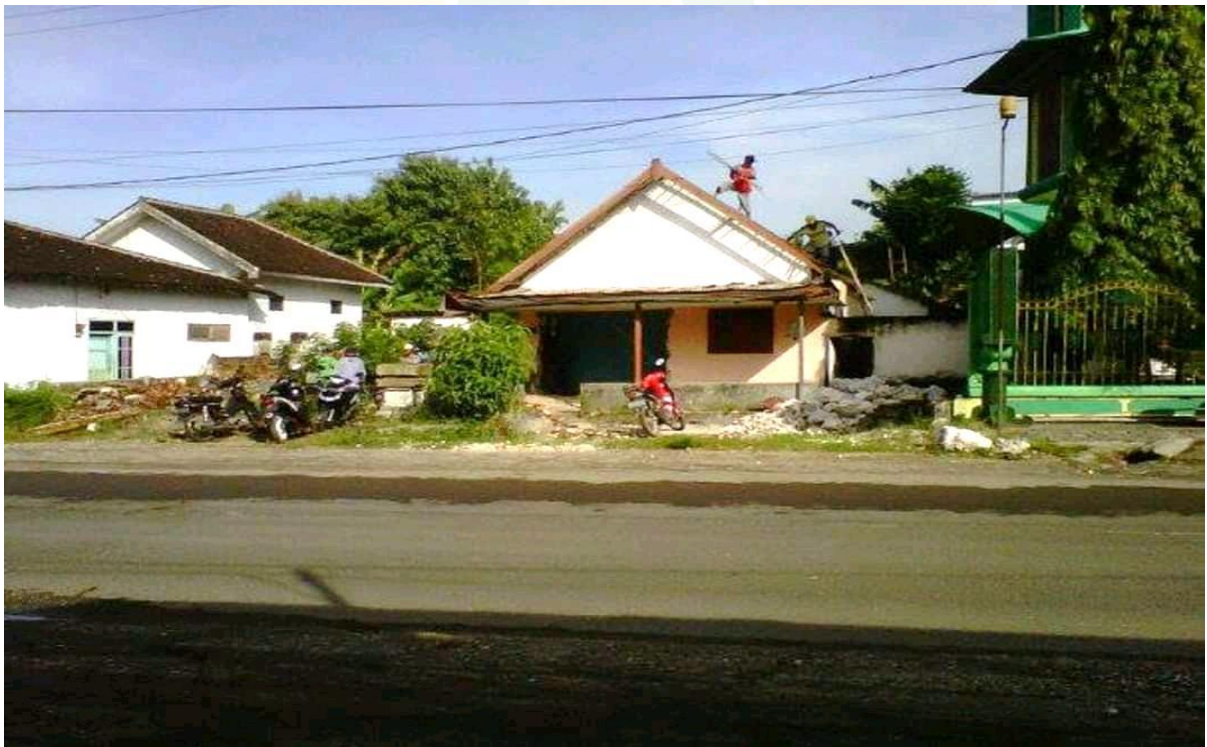
Gambar 4: kegiatan gotong royong masyarakat muslim dalam membangun rumah masyarakat di Grenden Jember
