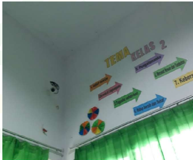
Gambar 4.1 CCTV di Ruang Kelas 90
