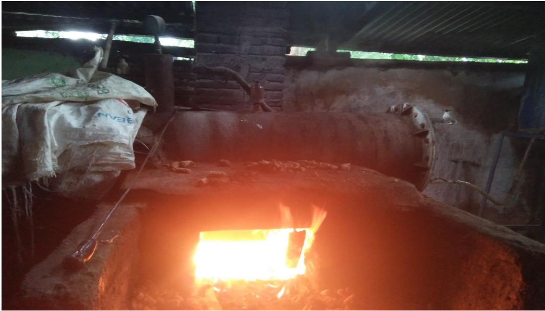
Ketel uap dengan sistem pembakaran menggunakan kayu
