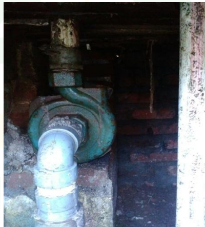
8. Pompa air craft di CV. Halim Jaya Abadi
