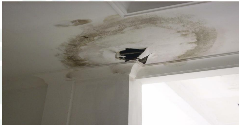
Gambar 4.5 Salah satu plafon sekolah yang rusak
