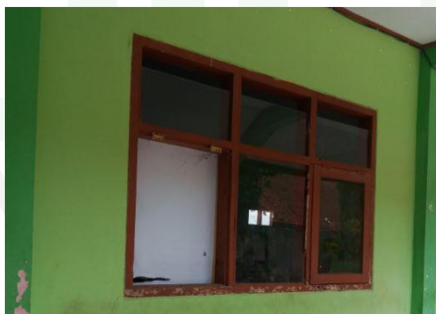
Gambar 4.8 Penampakan jendela ruang kelas yang rusak
