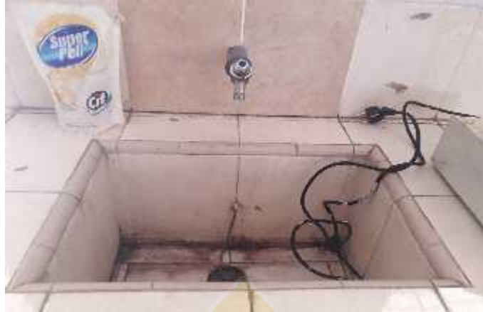
Gambar kondisi keran air yang rusak dan kotor
