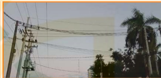
Sumber : Dok pribadi Gambar : 1.13 kabel kendur
