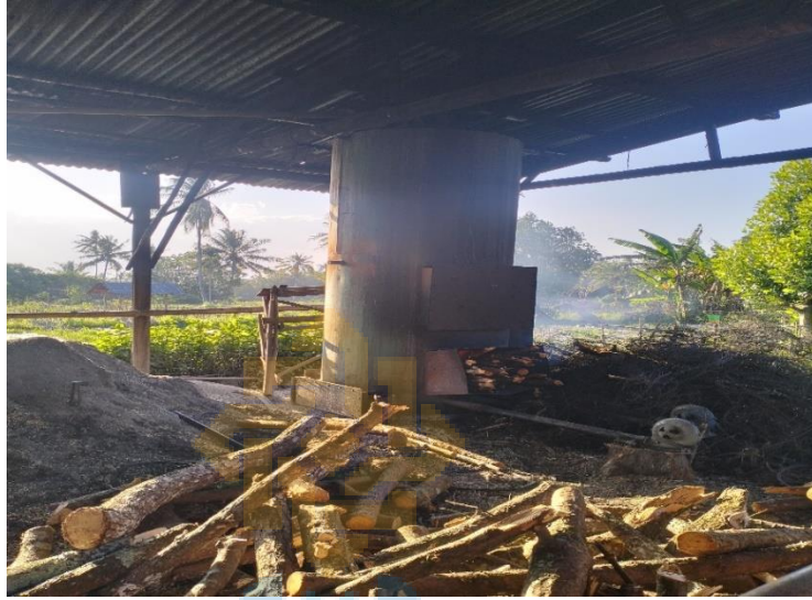
Ketel Uap Pemasak Kedelai.
