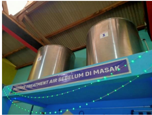
Penampungan air yang sudah di filter sebelum dimasak
