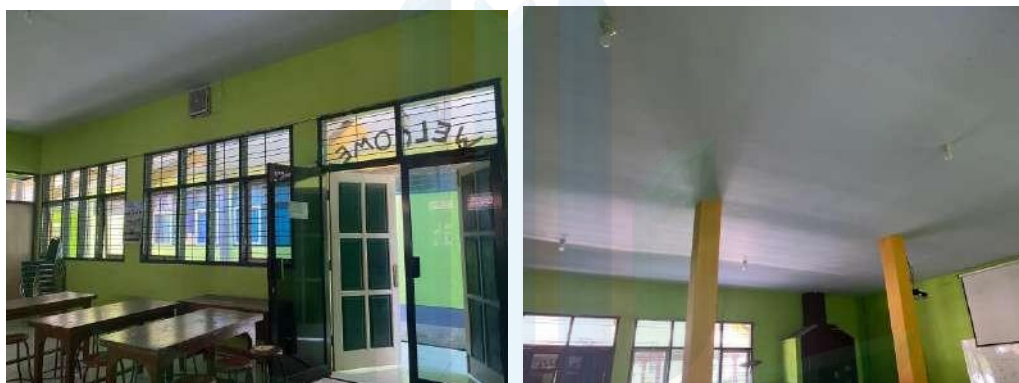
Gambar 4.2 Ventilasi dan Bola Lampu di Ruang Laboratorium
