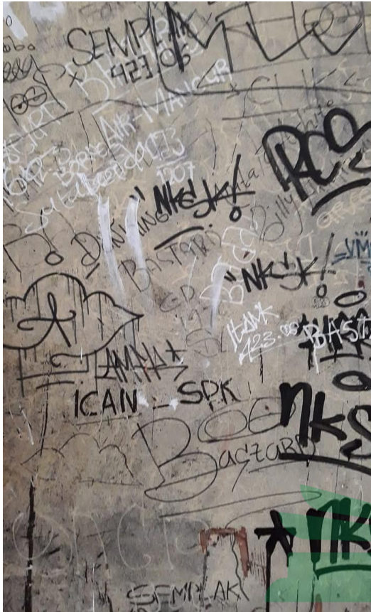
Fasilitas sekolah yang di vandalisme
