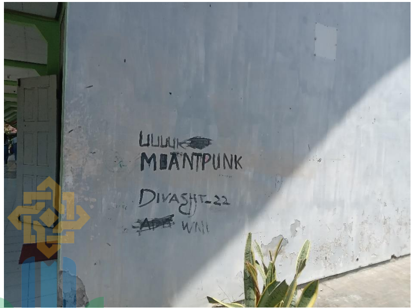
Fasilitas sekolah yang dirusak
