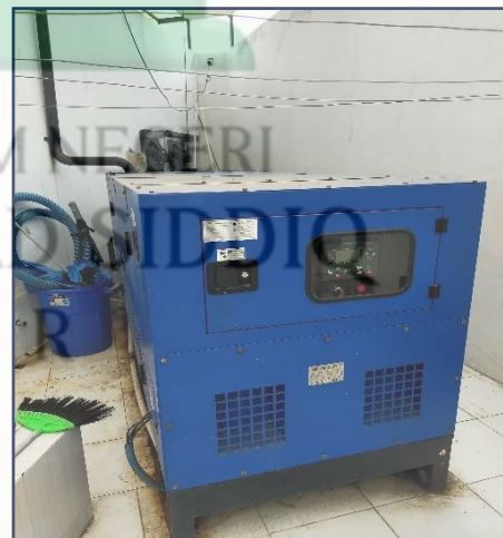
Aset Tetap Genset
