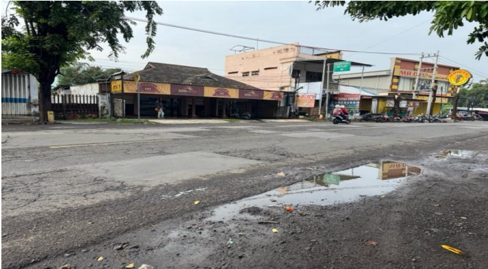
Gambar : Jalam Pantura yang rusak
