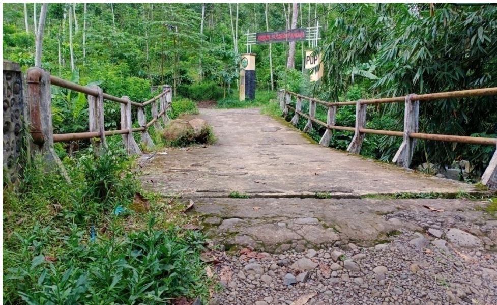
Gambar 3: Jembatan rusak akibat pekerjaan pengangkutan pohon sengon
